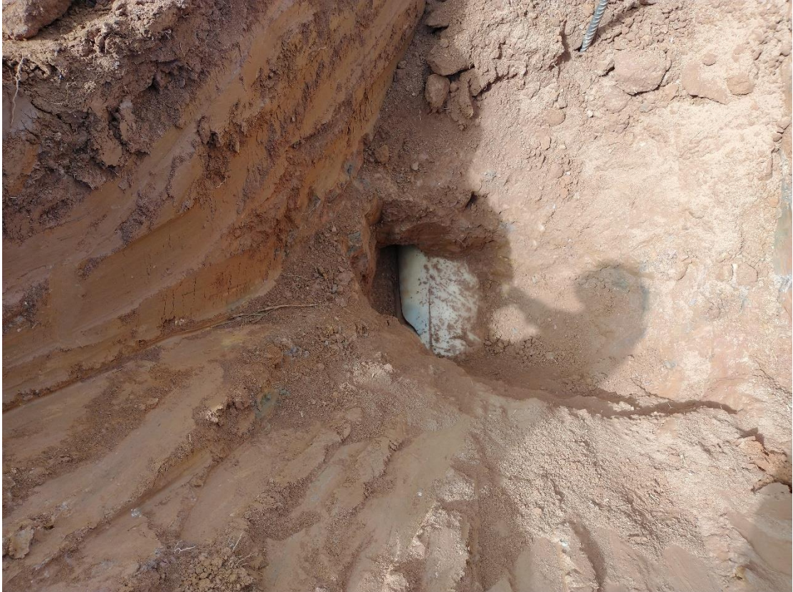
Poço de visita para exposição do duto e observação das avarias no revestimento.
