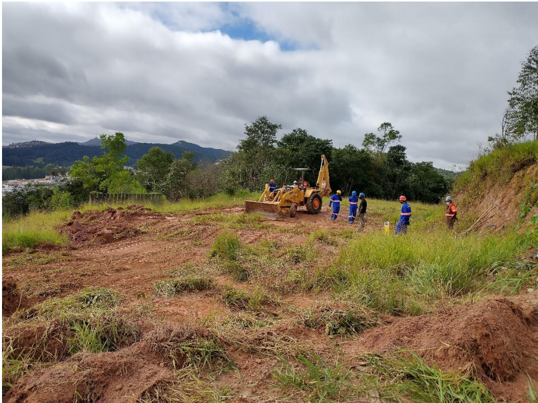
Início dos trabalhos na Faixa de Dutos com remoção da cobertura vegetal.
