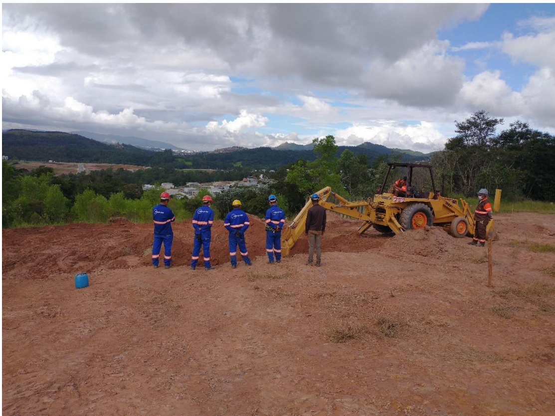
Rebaixamento do terreno para facilitar as novas escavações para execução das jaquetas de concreto previstas em projeto
