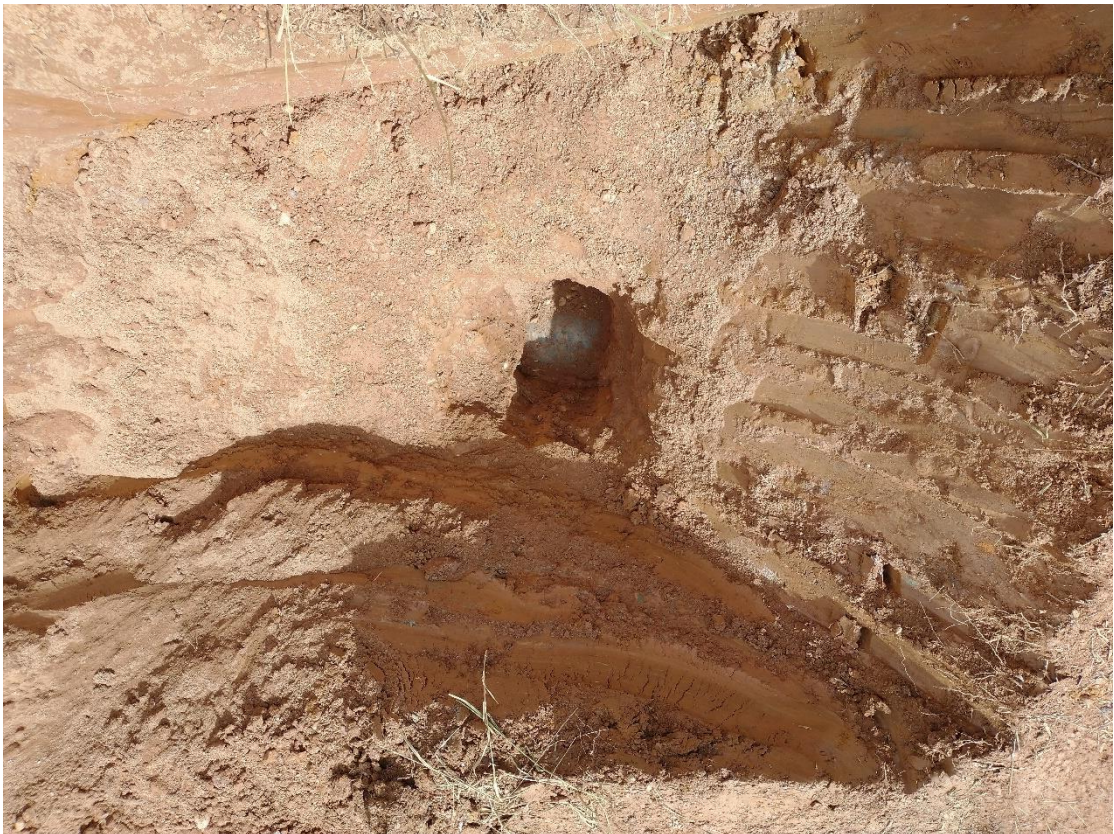
Poço de visita para exposição do duto e observação das avarias no revestimento
